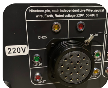
Testigo LED por circuito
