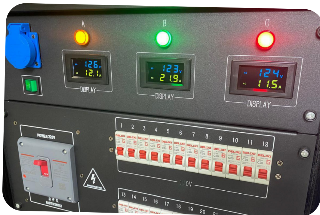
Break principal e instrumento de medición por fase
